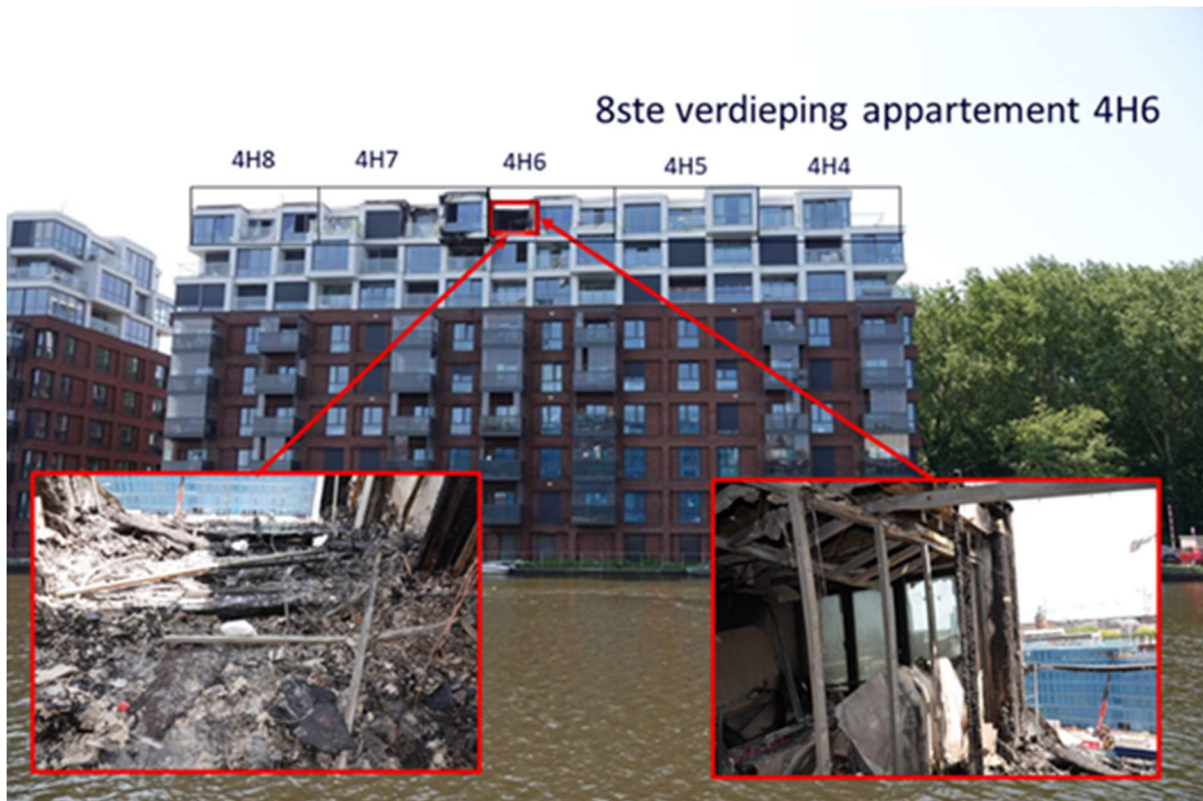
Afbeelding 3.4 De schade op de achtste verdieping
